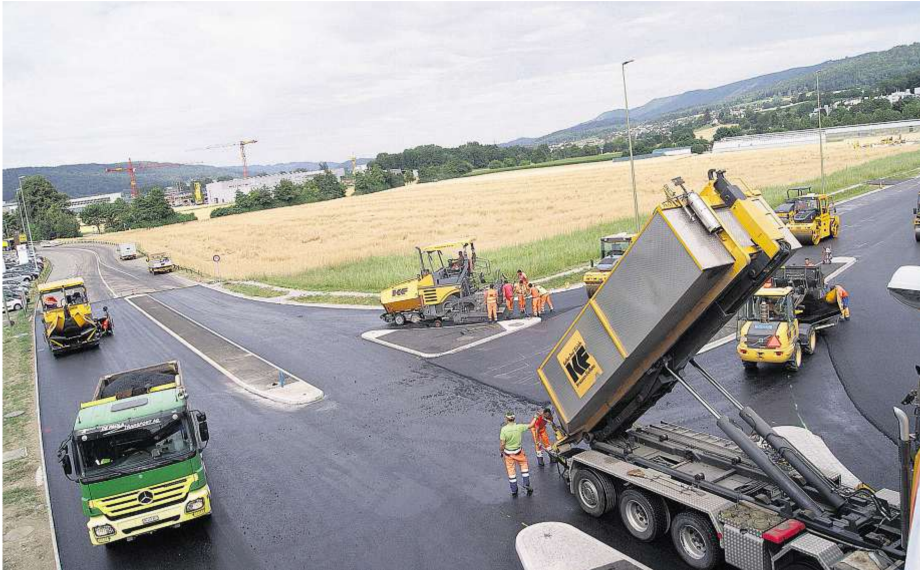
Nur wenige Stunden nachdem der alte Belag am Adliker Kreuz entfernt worden ist, wird der neue aufgetragen. Angeliefert wurde er von rund 200 Lastwagen.
